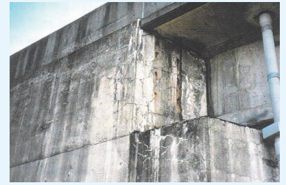
図1 凍結防止剤の散布により劣化した RC 橋台
