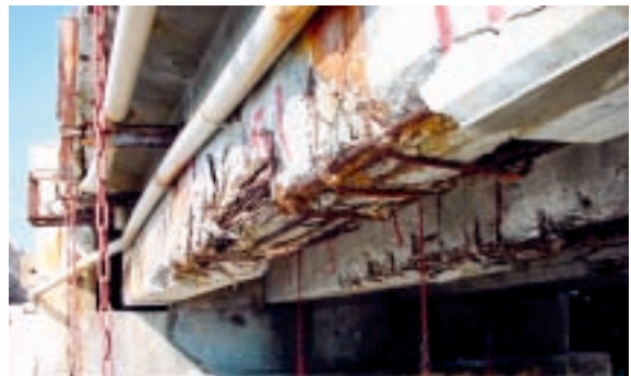
塩害による劣化事例
